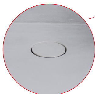
la grille de finition de l'évacuation se trouve au même niveau que le receveur de douche
